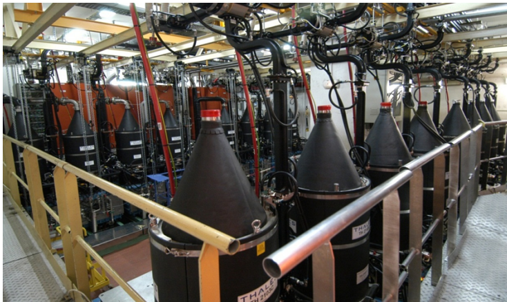
Tore Supra LHCD generator (16 klystrons)
